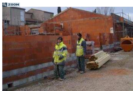
La résidence de Villemoustaussou est en construction. Elle sera livrée en fin d'année et les demandes sont déjà très nombreuses. / Photo DDM P.A.
